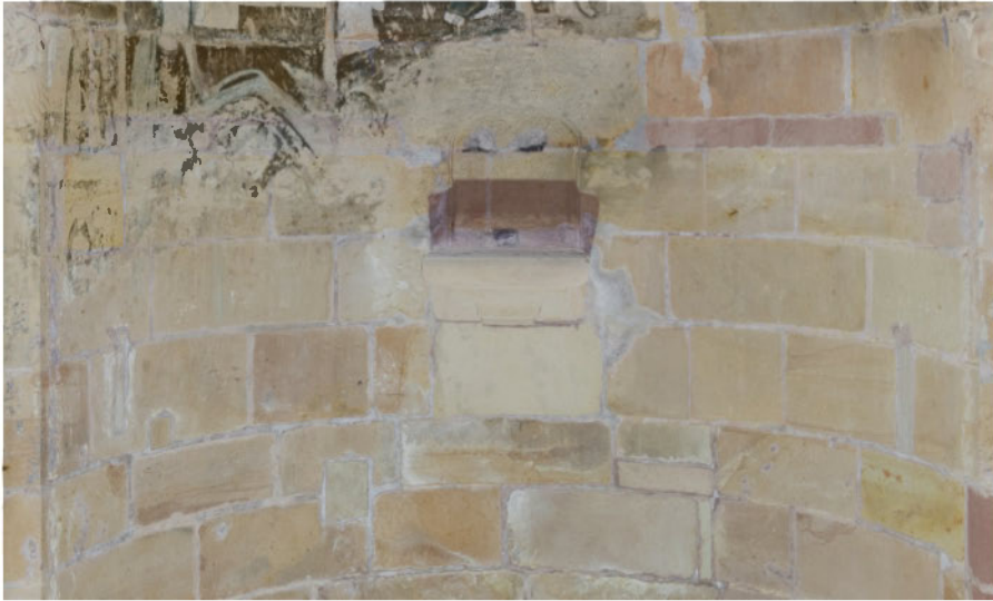
Fig. 55. En esta imagen se pueden ver los daños y cambios producidos en esta parte de la capilla. (Fuente: Imágenes de la autora y de Olga Cano)
