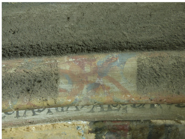
Fig. 58. Este ejemplo nos sirve para poder visualizar la capa que encontramos a nuestra llegada en la cornisa, acumulación de polvo, partículas de pigmentos, sales y partículas de piedra acumuladas. Al realizar una cata de limpieza encontramos la decoración original de la cornisa, trazos aplicados arbitrariamente de pintura al temple de distintos colores: rojo, naranja y azul. (Fuente: Imagen de la autora y Olga Cano)
