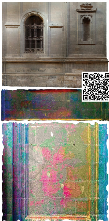
Fig. 7. Modelo 5 realizado sobre paramento localizado junto a la puerta puerta de San Jerónimo. Arriba fotografía sin análisis de imagen y abajo con análisis del filtro LRE. (Fuente: Ilustración de los autores)
