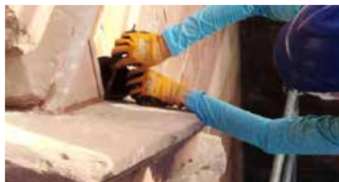
Fig. 34. Rejuntado de zonas sin mortero de junta o en mal estado de conservación. Ejemplo de rejuntado en el alero del frontón. (Fuente: Fotografía de los autores)
