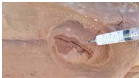
Fig. 28. Sellado de grietas y fisuras donde hay peligro de desprendimiento de materia, en la zona del escudo y en alguno de los bloques del muro. (Fuente: Fotografía de los autores)
