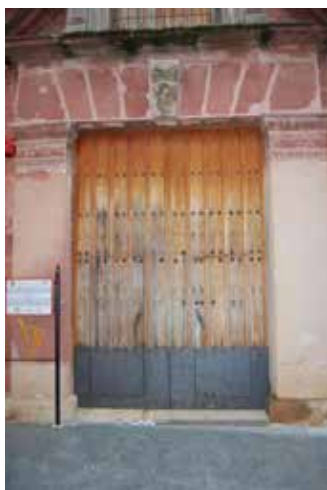
Fig. 25. Falta de barniz y sequedad de la madera, falta de clavos decorativos y oxidación del hierro por la falta de la capa de protección de metal. (Fuente: Fotografía de los autores)
