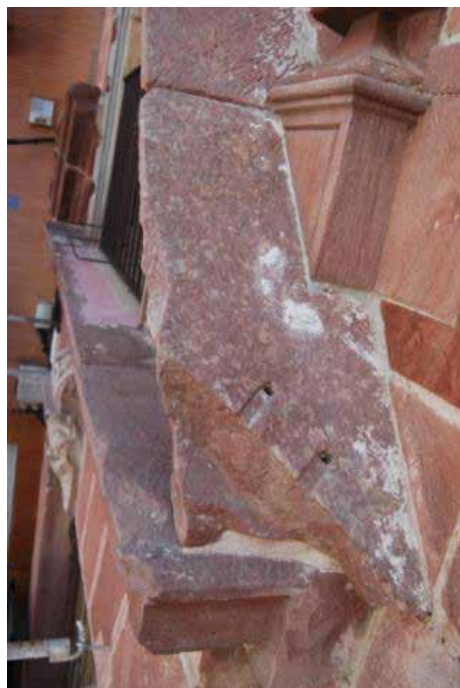
Fig. 16. Cornisa original con muchas pérdidas de material debido a golpes y erosión. Detalle de la esquina derecha del frontón original, donde se aprecia que falta la esquina, se realizaron dos agujeros para colocar la parte faltante pero esta parte ya no está en la fachada. (Fuente: Fotografía de los autores)
