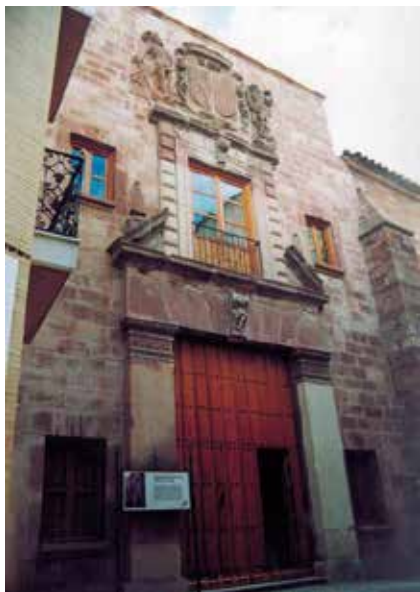
Fig. 3. Estado de conservación antes de la intervención. (Fuente: Ayuntamiento de Bailén)
