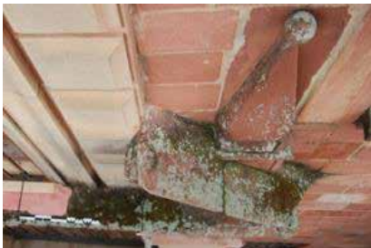
Fig. 15. Detalle de crecimiento biológico en el alféizar de las ventanas y en las cornisas de las molduras del frontón. (Fuente: Fotografía de los autores)
