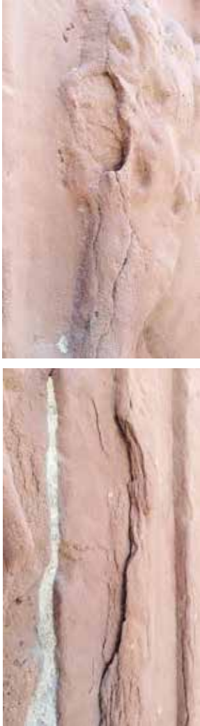
Fig. 17. Detalles de grietas y fisuras que han producido pérdida de material y disgregación granular. (Fuente: Fotografía de los autores)
