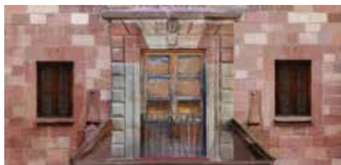
Fig. 9. Balcón del segundo piso, vista después de la restauración (Fuente: Ortofoto, L. Chapon)
