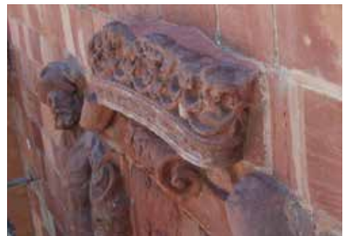
Fig. 30. Relleno de la zona superior de la corona con mortero entonado, se ejecuta en talud para ayudar a la caída del agua y evitar depósitos de tierra y humedad. (Fuente: Fotografía de los autores)
