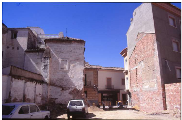
Figs. 8, 9 y 10. La capilla o camarín “descubierta” de edificaciones durante las obras de demolición del antiguo cuartel de la Guardia Civil sobre el solar donde se levantaba la ermita de Consolación. Obsérvese el acceso cegado que comunicaba la capilla de Jesús Nazareno con la ermita de Consolación y el desnivel de la planta. (Fuente: Miguel Ruiz Calvente).
